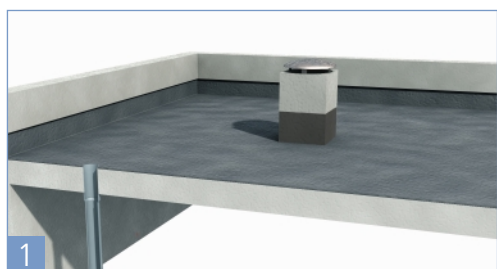
1 Mise en place de l'étanchéité Conformément aux prescriptions de l'Avis Technique n°5/04-1793.
