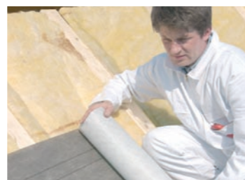
L'écran de sous-toiture est posé en contact direct sur la laine de verre
